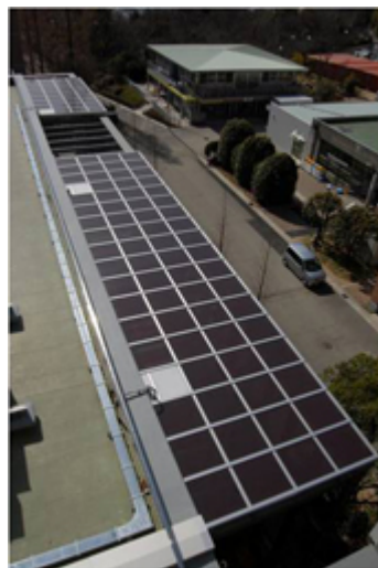
工学研究科本館屋上に設置した 太陽光パネル
