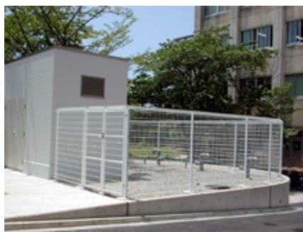
中和・曝気槽
