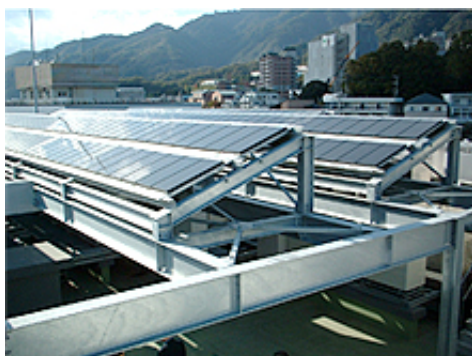
自然科学総合研究棟3号館 太陽電池パネル
